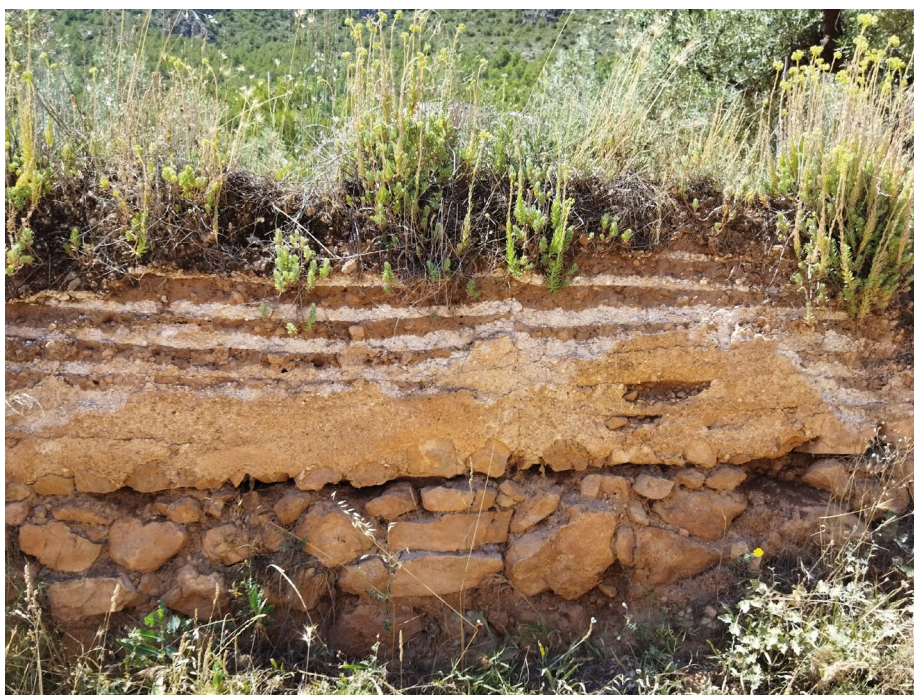
Figura 7. Tapia exterior, zócalo de piedra y muro de tapial con tongadas de tierra y cal
